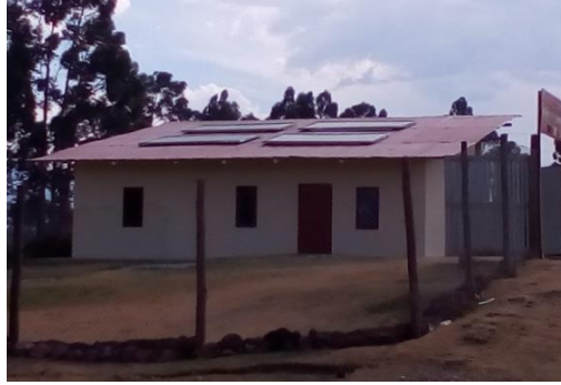
Foto 9.- Juego de paneles solares instalados en el techo con inclinación de 15°C
