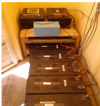
Foto 7.- Banco de baterías
